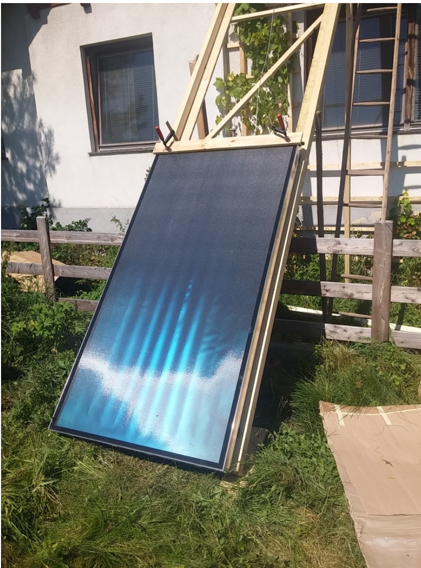
Flachkollektor am Aufzug
