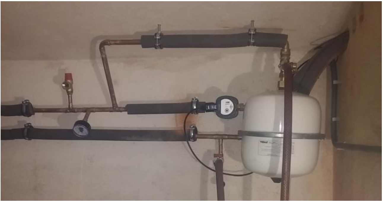
Befüllung des Heizkreislaufs im Keller
